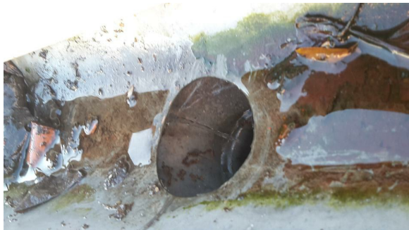
Hul i tagrende over nedløbsrør
