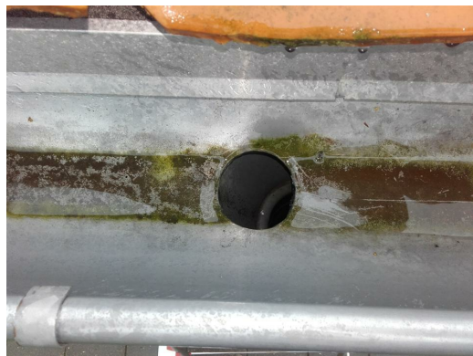
Hul i tagrende over nedløbsrør
