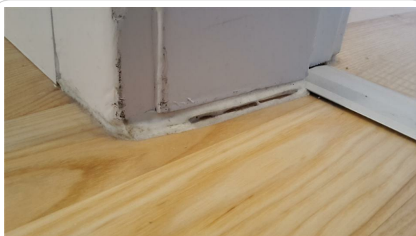
Gulvskinne og elastisk fuge har sluppet gulvet.
