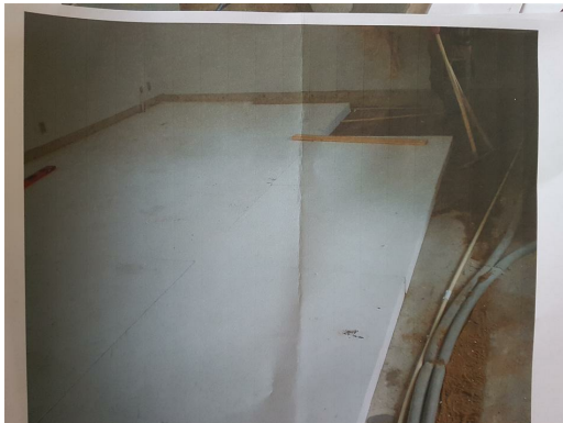
Billede 1. Sammenstripsede rør, adresse ukendt
